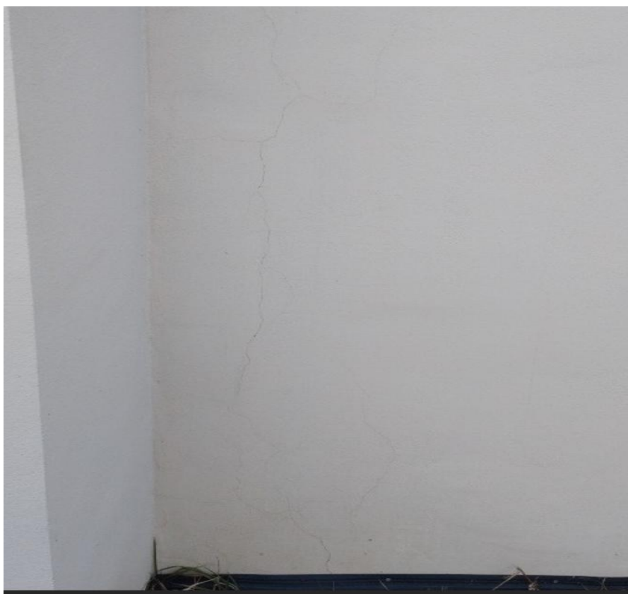
Obrázek 23: Aktuální fotografie zadní stěny č.p. 115 vč. nových trhlin
